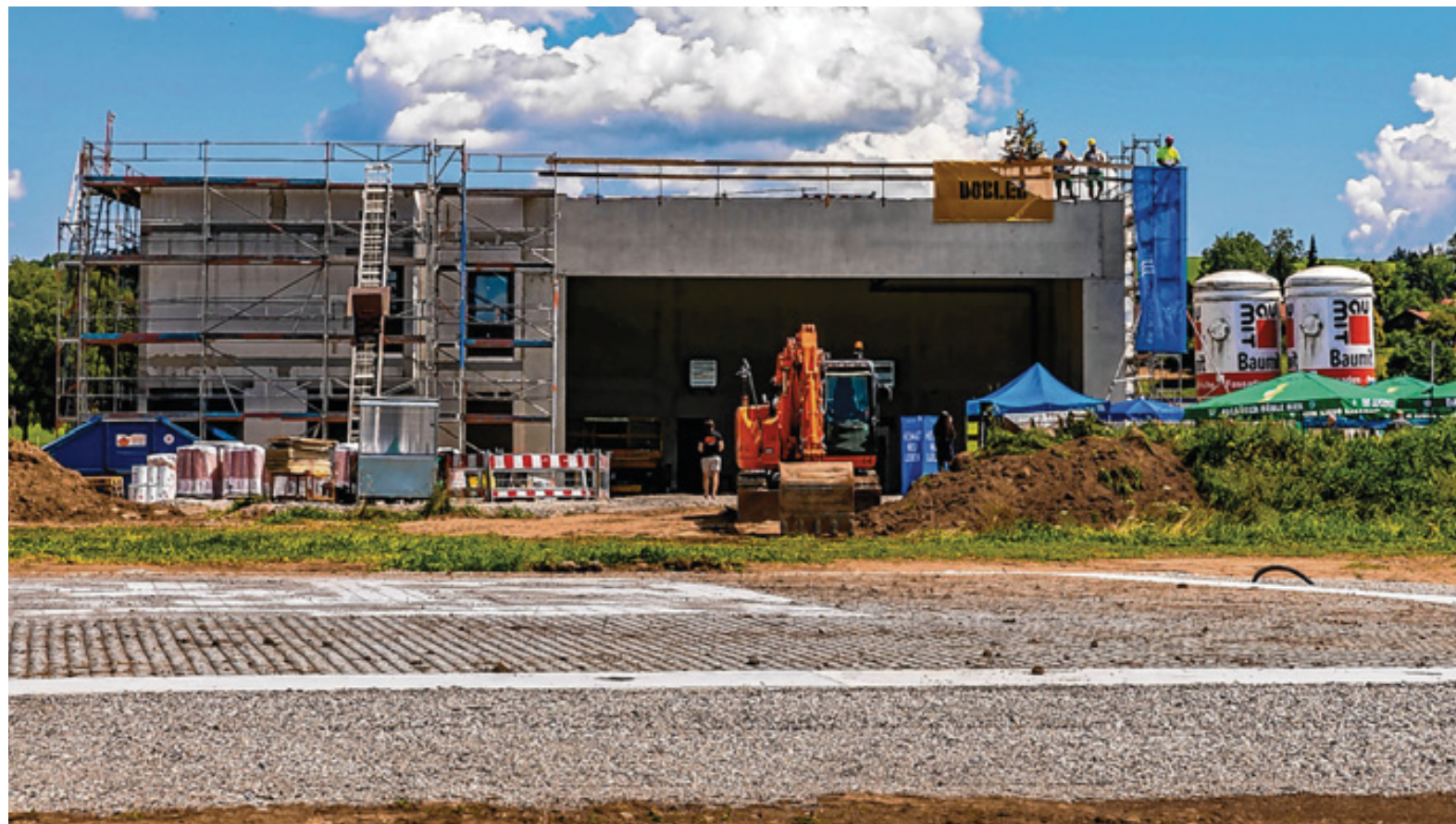
Beim Verkehrslandeplatz Kempten-Durach steht der Rohbau für den künftigen Hangar des Rettungshubschraubers Christoph 17. Gestern wurde Richtfest gefeiert.
